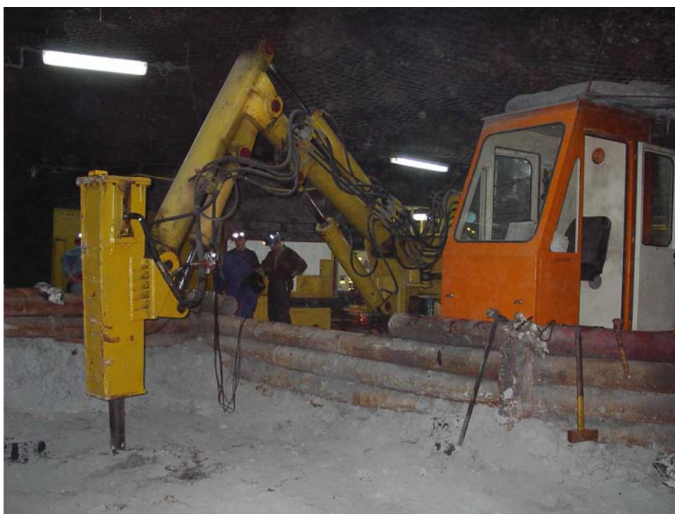
Rys. 9.1. Miejsce badań dołowych wytypowanych młotów hydraulicznych – krata nr 41
