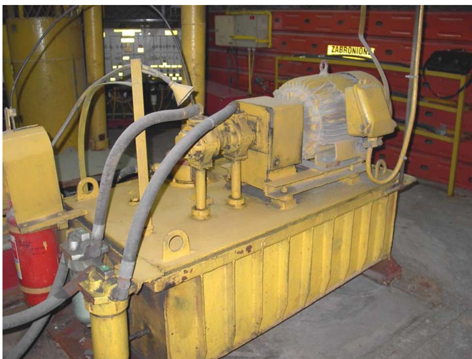
Rys. 9.2. Agregat hydrauliczny zasilający wysięgnik stacjonarny oraz zamontowany na nim młot hydrauliczny
