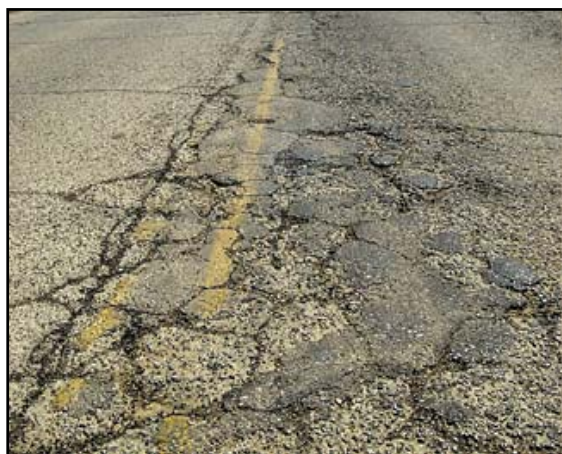
Rys. 2.3. Spękania zmęczeniowe nawierzchni drogi
