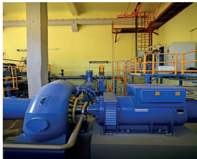
Rys. 8. Widok turbiny wraz z generatorem
