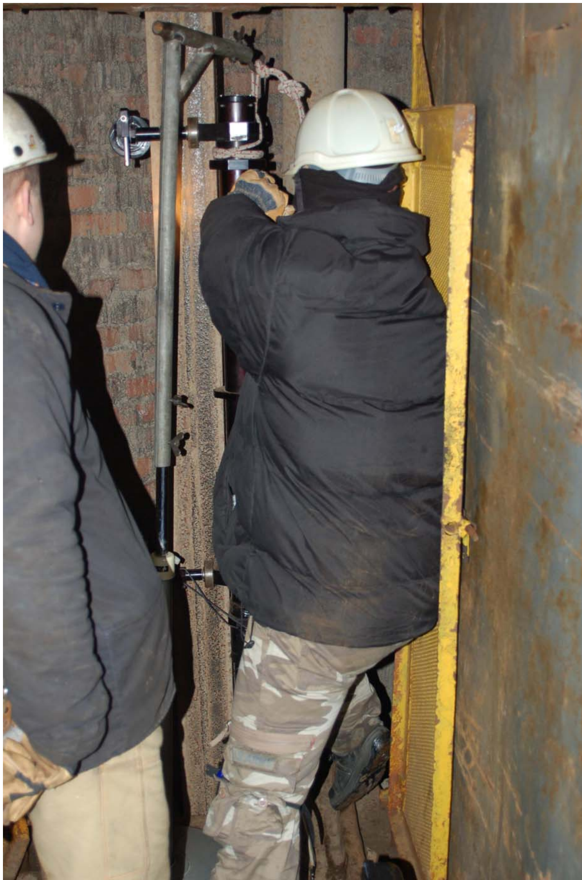
Rysunek 3.3. Pomiar ciągu przewodniczego z wykorzystaniem inklinometru szybowego.
