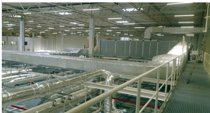
Rys. 11. Widok wykonanej instalacji
