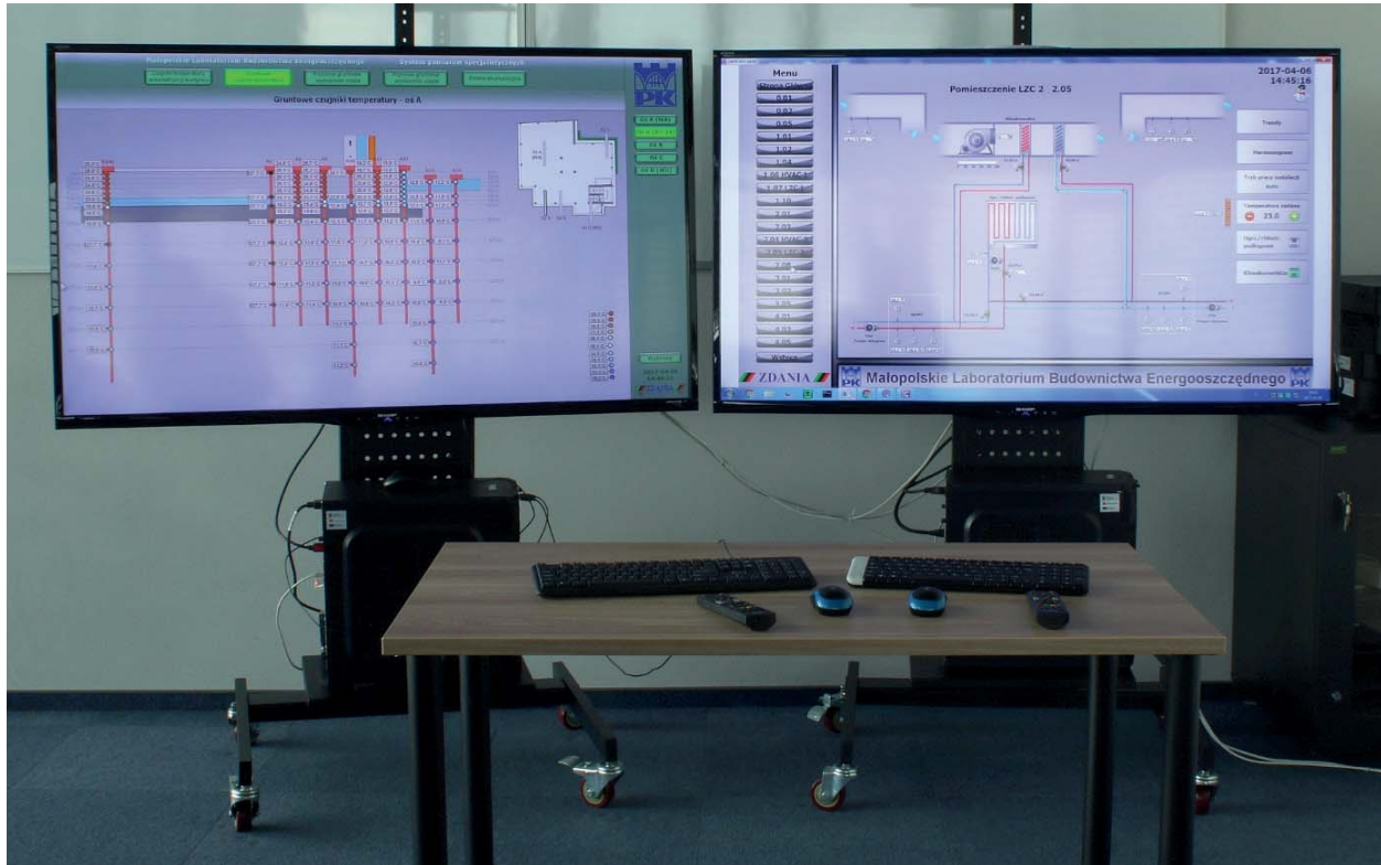
Rys. 2. Stacje operatorskie zintegrowanego systemu SSO (z lewej – widok opomiarowania gruntu pod budynkiem) i BBMS (z prawej – widok jednej z pomieszczeniowych instalacji HVAC)
