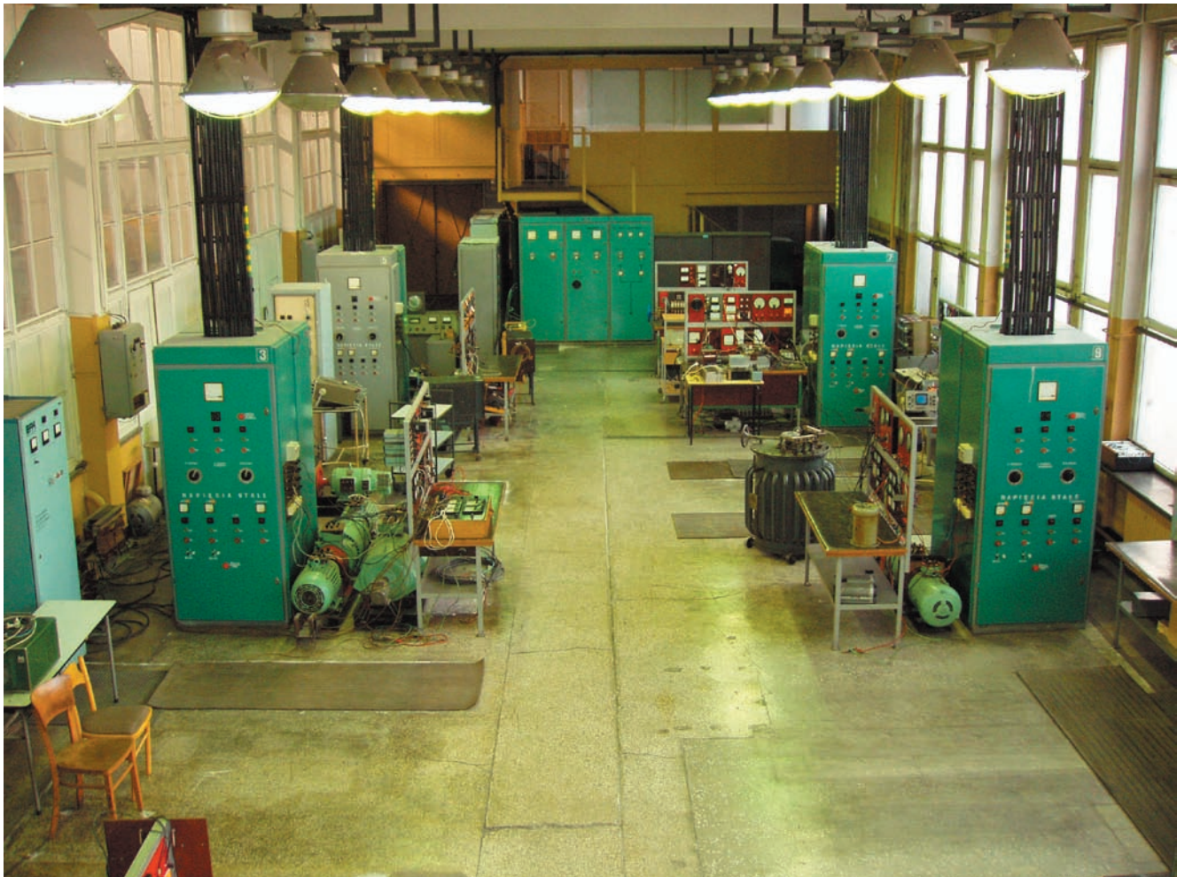
Laboratorium Napędu Elektrycznego (Wydział EAIiE)
