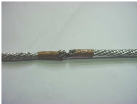
Rys. 8.9. Widok uszkodzenia 1 – pęknięta linka
