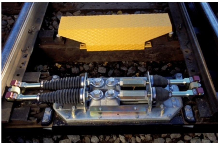
Rys. 17. Zabudowany EBI Switch 2000 z usuniętą pokrywą. [84]
