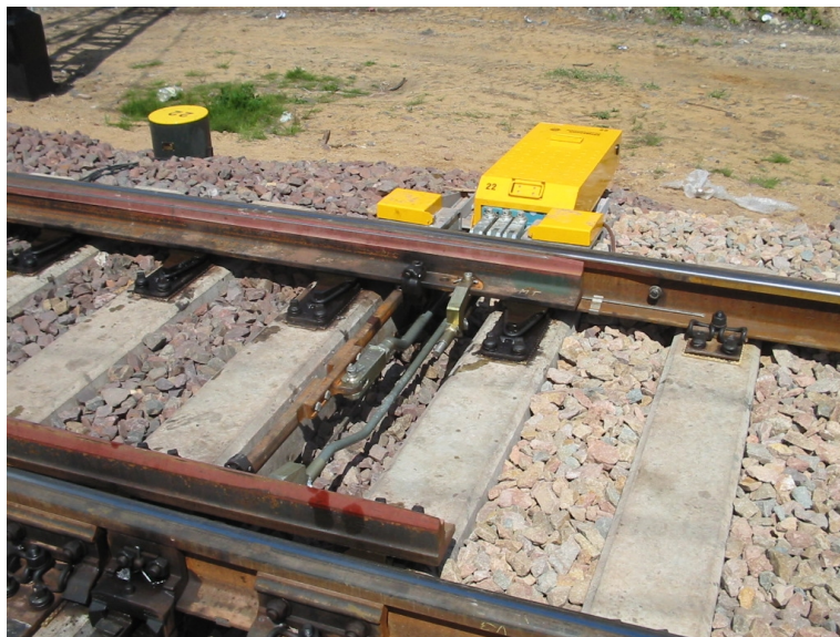
Rys. 25. Napęd zwrotnicowy zabudowany przy rozjeździe.
