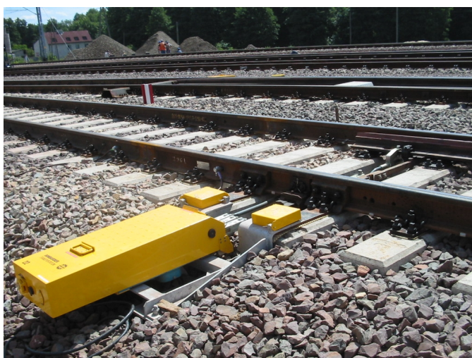
Rys. 4. Napęd zwrotnicowy EEA-5 zabudowany w rozjeździe.
