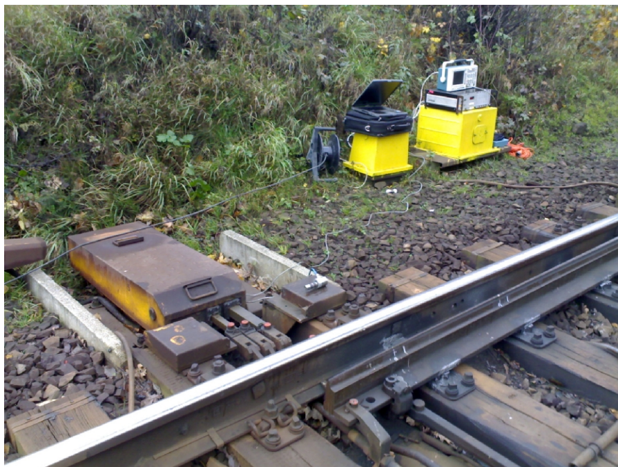
Rys. 87. Badany napęd nr 1 na stacji Kobiór.
