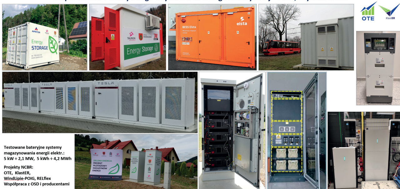
Rys. 16. Zdjęcia badanych i testowanych BSMEE (moce: od 5 kW do 2,1 MW, pojemności: od 5 kWh do 4,2 MWh)
