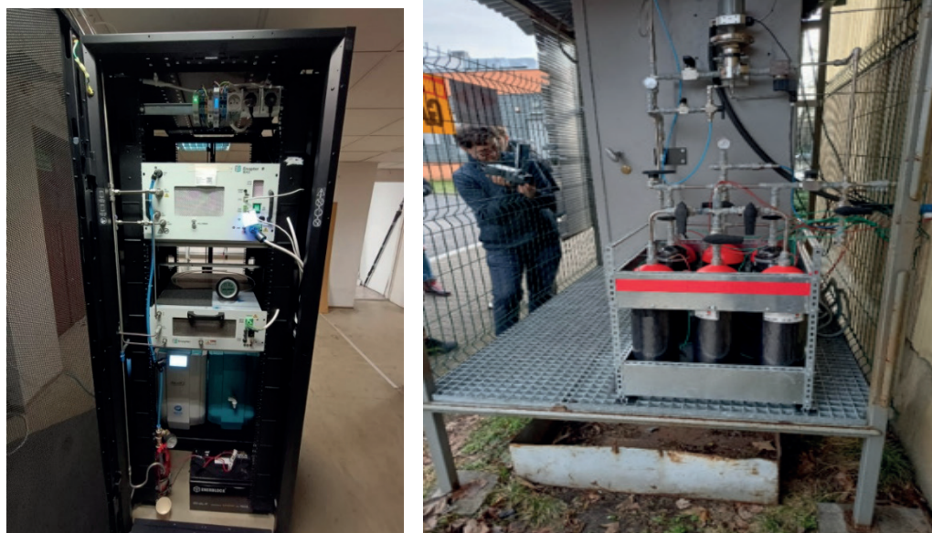
Rys. 5. Instalacja wodorowa wraz z elektrolizerem oraz układem magazynowania wodoru w zbiornikach kompozytowych (fot. Magdalena Dudek)
