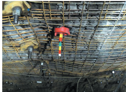
Rys. 3.65. Rozwarstwieniomierz zainstalowany w stropie wyrobiska wykonanego w samodzielnej obudowie kotwowej
