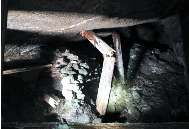
Rys. 3.43. Niszczenie stojaków drewnianych w wyniku zaciskania pionowego w nieczynnej komorze w KS Wieliczka
