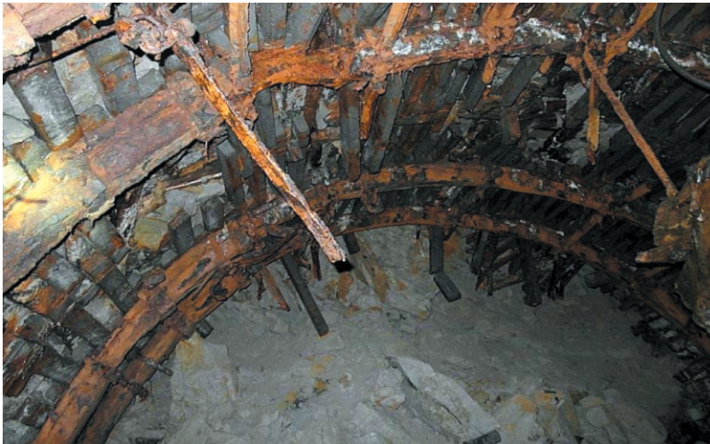
Rys. 4.19. Zawal skał stropowych spowodowany utratą nośności odrzwi w wyniku korozji (Ficek, 2022)
