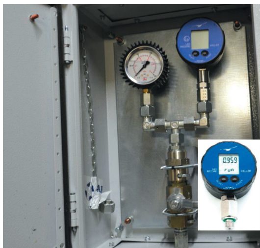
Rys. 4.4. Manometr glicerynowy oraz manometr z pamięcią połączone w jeden układ pomiarowy obciążeń obudowy podporowej
