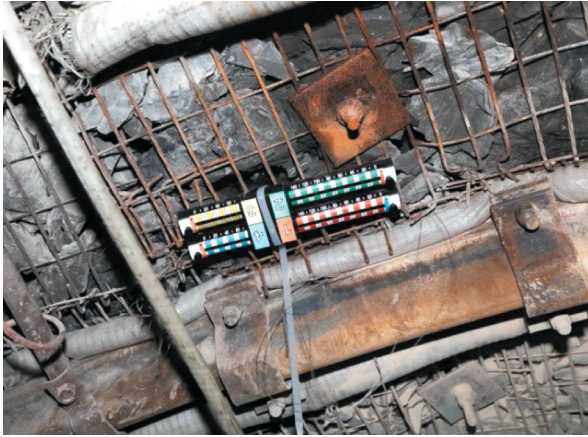
Rys. 3.71. Rozwarstwiomierz Gen4 Rock IT zamocowany w stropie chodnika PW-1
