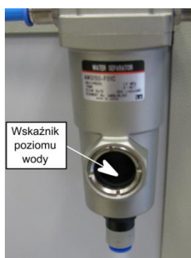
Rys. 4. Wskaźnik poziomu wody kompresora.
