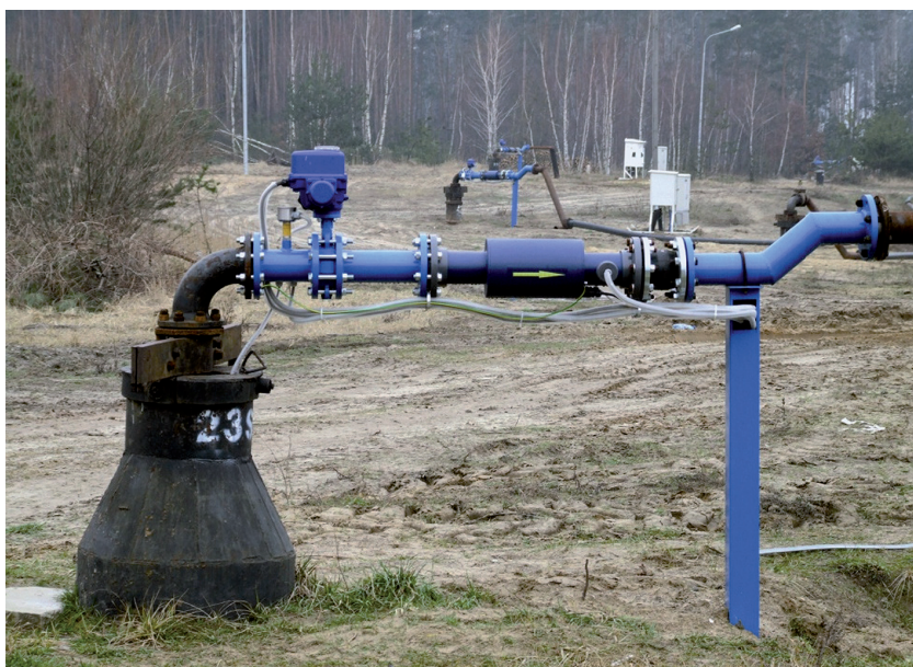
Rys. 2. Studnie bariery ochronnej [6]
