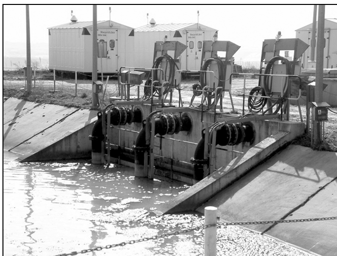
Rys. 14. Pompownia z trzema pompami zatapialnymi OZ-400 [6]
