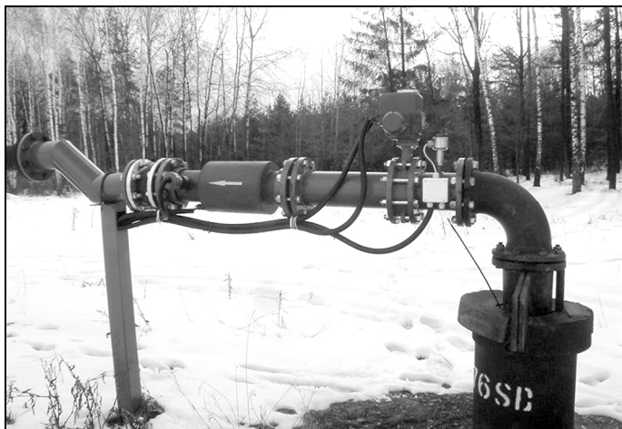
Rys. 4. Urządzenia pomiarowe studni [6]
