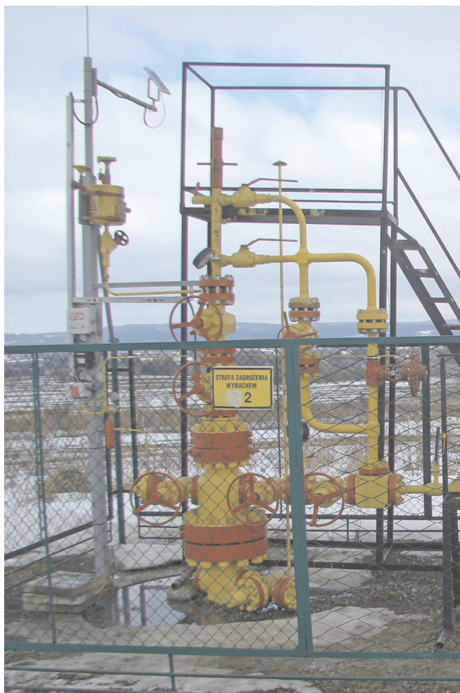
Rys. 2. Głowica odwiertu Moderówka 6 z zainstalowanym gazodźwigiem nurnikowym
