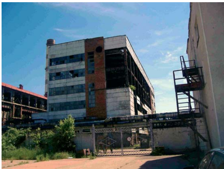
Fig. 5. Zniszczone budynki nieczynnej kopalni soli potasowej w Kałuszu
