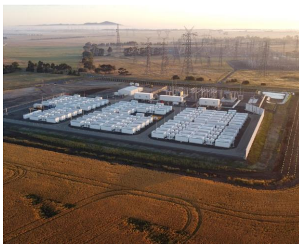
Rys. 1.1 Magazyn energii Victorian Big Battery zbudowany z Megapack’ów Tesla o mocy 350 MW. [13]
