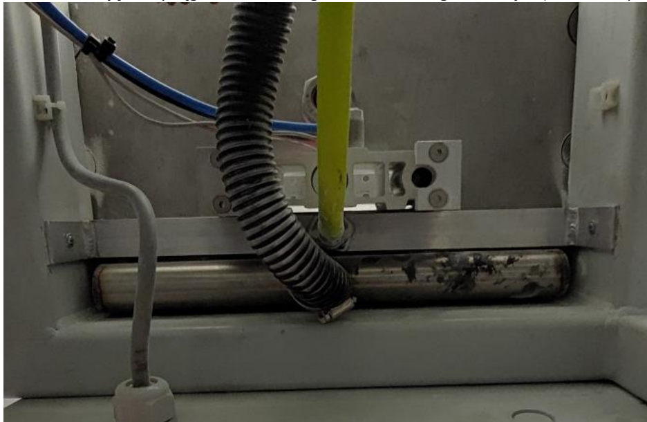
Rysunek 5.12. Zdjęcie wyciągu mechanicznego zamontowanego na stacji 1 (widok od spodu).
