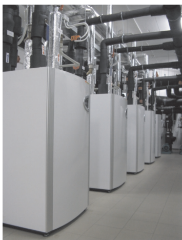
Rys. 3. Pompy ciepła Greenline D70 zainstalowane w podziemiach Nowego Audytorium
