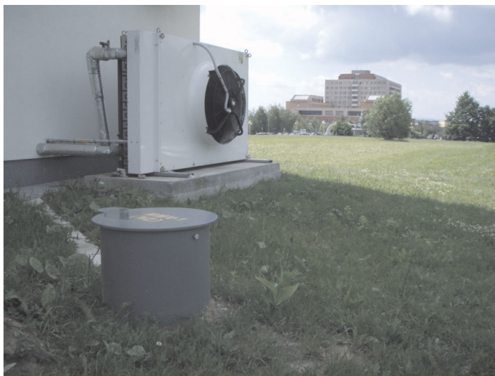
Rys. 6. Szybik płytkiego otworu monitorującego MMV-1
