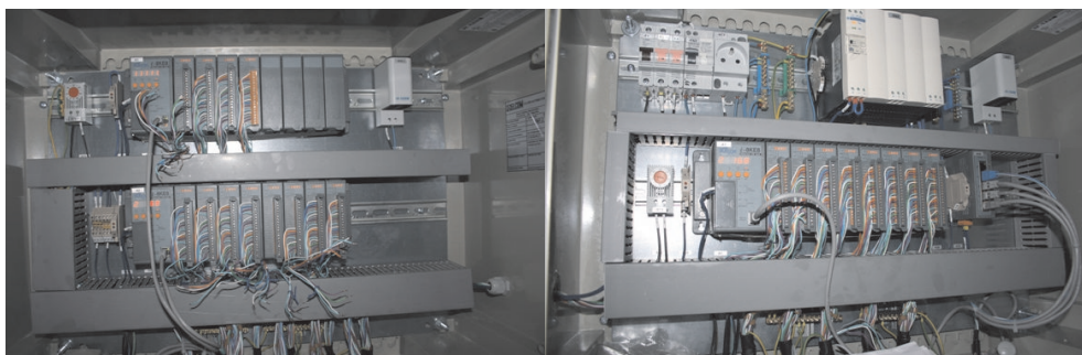
Rys. 6. Widok tablicy rozdzielczej RM1
