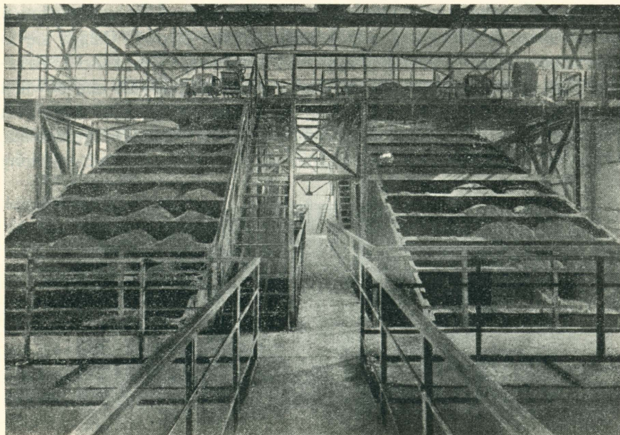
Rys. 9. Taśmy odwadniające dla mialu węglowego systemu Bauma (z katalogu Bauma, Herne).
