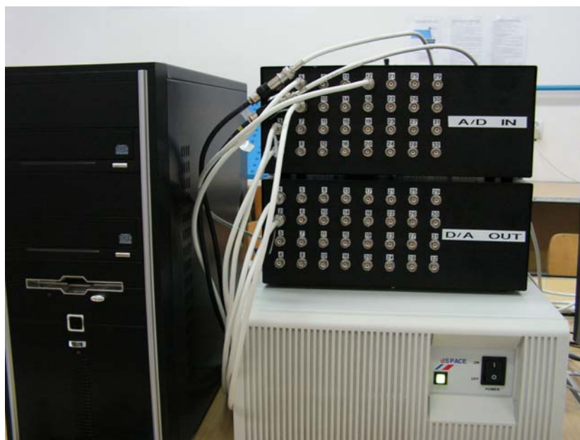
Rys. F.2. Skrzynki złącza sygnałów pomiarowych i sterujących
