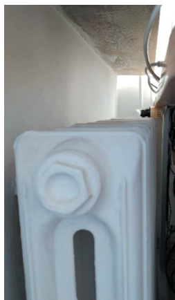
Rys. 20. Widok II na głowicę termostaticzną grzejnika członowego i jej okolice
