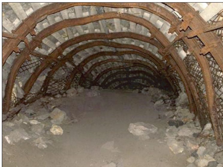
Rys. 275. Wyrobisko korytarzowe w obudowie łukowej zdeformowane pod wpływem obciążenia [38]
