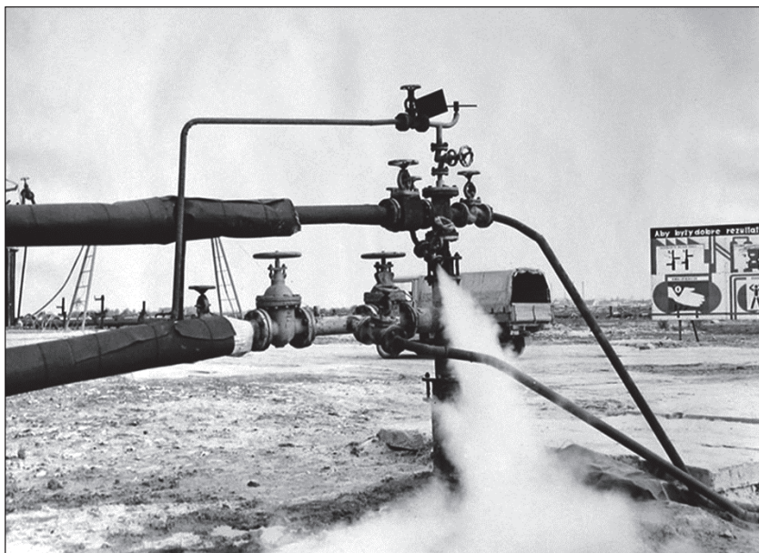
Rys. 348. Głowica otworu wiertniczego, eksploatacyjnego – podziemny wytop siarki [196]
