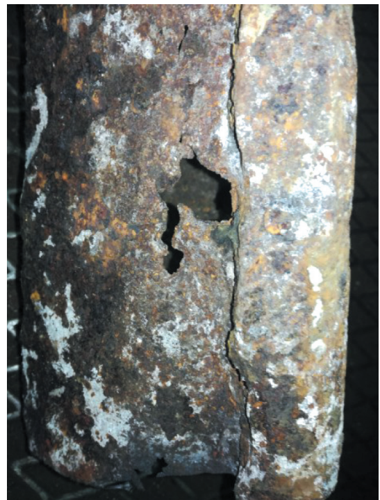
Rys. 2. Perforacja kształtownika w rejonie jego kołnierza
