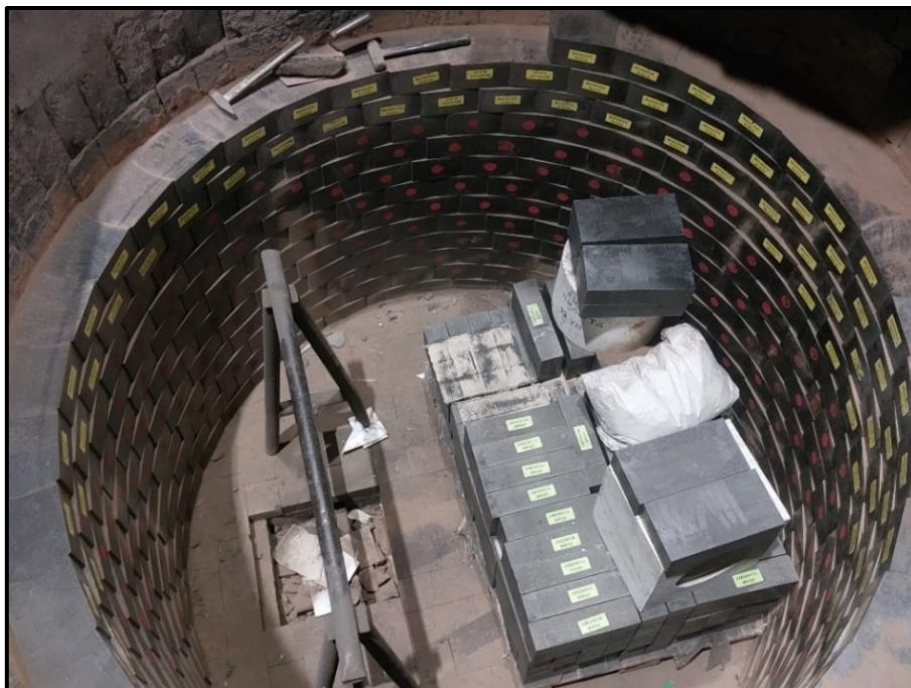
Rys. 61. Zabudowa wyższych warstw kadzi głównej. Widoczne przejście ze strefy metalu (czerwone oznaczenie) do strefy żuźla (żółte oznaczenie).
