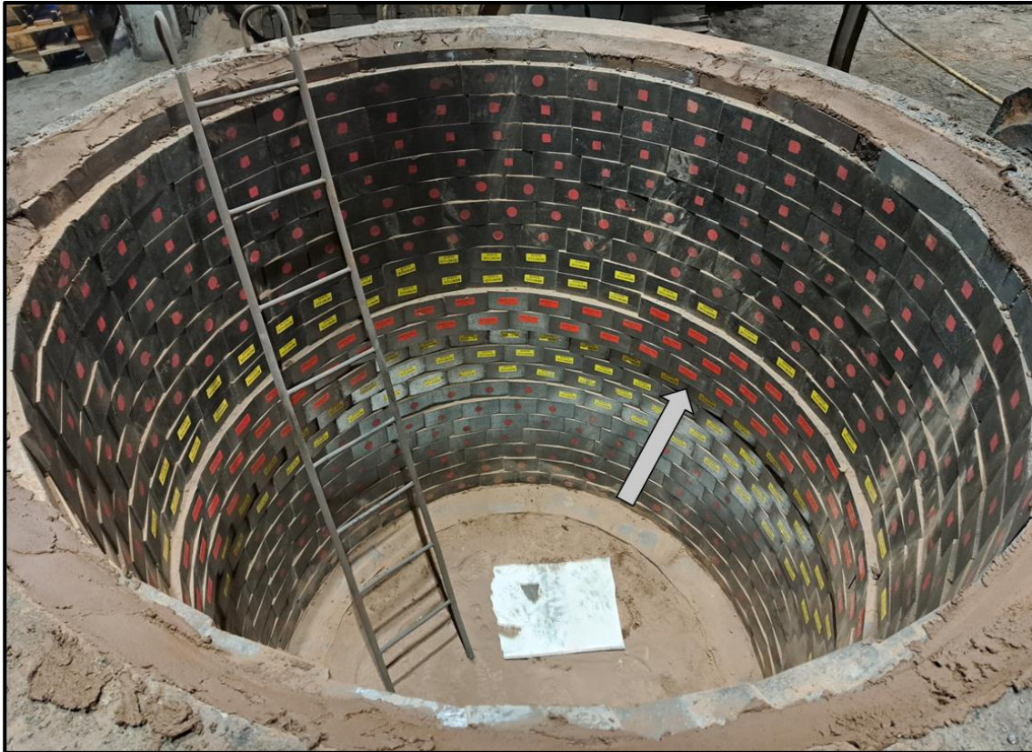
Rys. 62. Kadź główna z kompletną zabudową przygotowana do suszenia.
